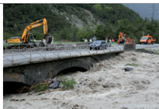
Les Gleizolles (04) crue de l'Ubayette mai 2008, le pont de la RD900 a été presque entièrement engravé (DDTM 06)
