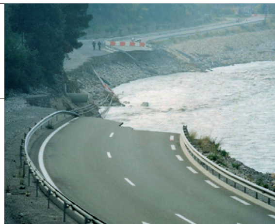
RD 6202, crue du Var de 1994 (DDTM 06)
