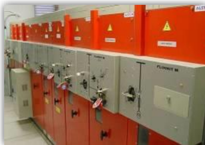
Cellules électriques du poste de livraison (source : CNR)
