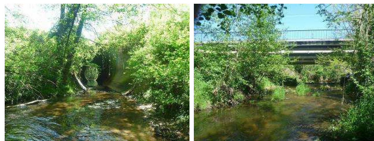
Figure 24. Photographies d'un des deux ouvrages de franchissement de la Sorme par la RN70 (à gauche) et de l'ouvrage de franchissement de la D357 (à droite).
