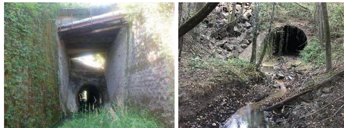
Figure 23. Photographies de l'ouvrage de franchissement des Marais par la RN70 (à gauche) et de la buse de franchissement de la zone industrielle (à droite).
