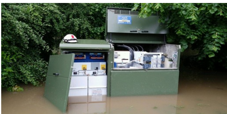
Poste d'électricité en zone inondée
