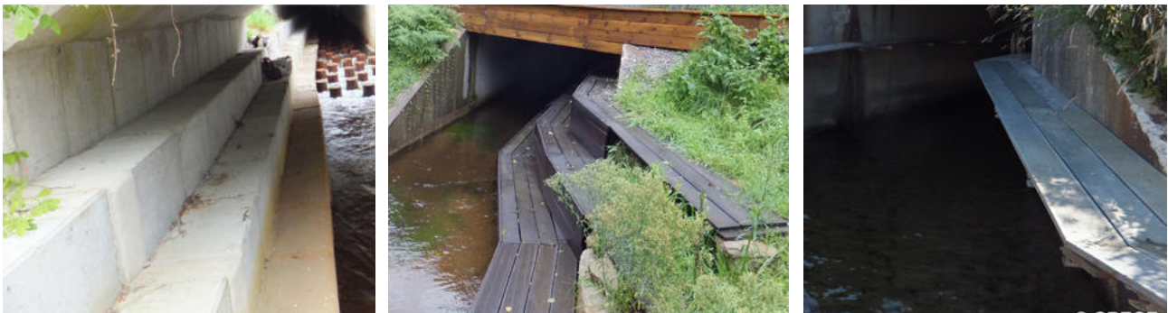
Illustrations de trois typologies de cheminement à sec mis en place dans des ouvrages hydrauliques existants (de gauche à droite) : banquettes en béton, banquettes en bois et encorbellement en bois
