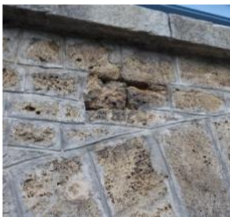
Fissure observée partie Est, façade nord du pont
