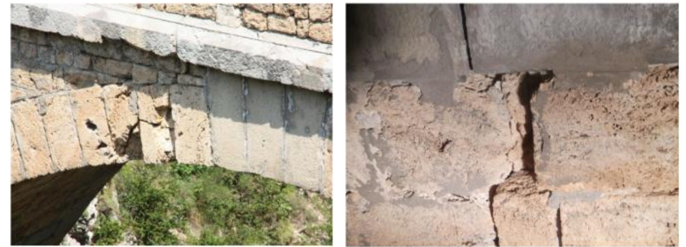
Photo 1 : De gauche à droite : Clé du bandeau amont côté rive gauche et disjointoiement et cavité. Source : CETE Méditerranée.
