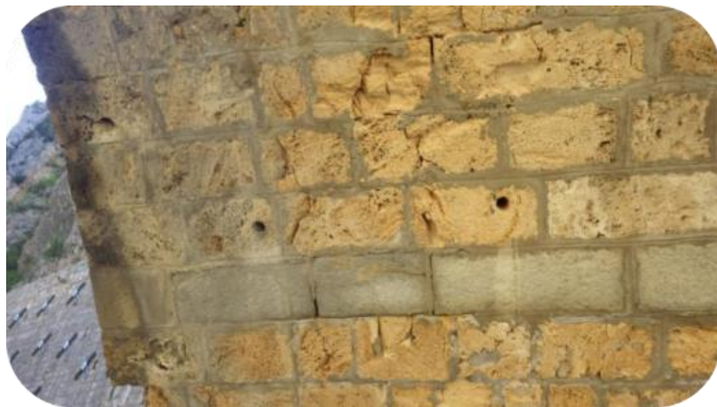
Zoom sur le bas de la façade Est du pont (drains favorables = encadrés noirs) - (©M. GAYAUD, 2015)
