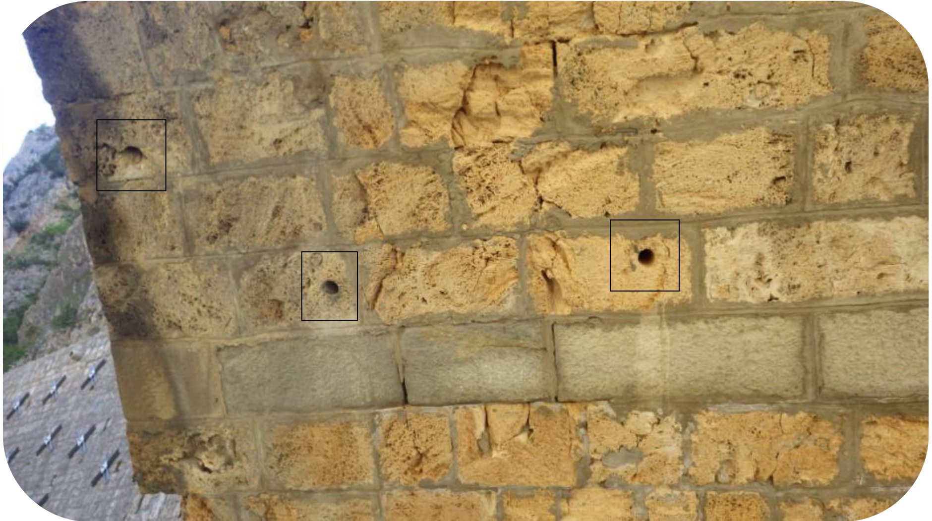
Zoom sur le bas de la façade Est du pont (drains favorables = encadrés noirs) - (©M. GAYAUD, 2015)
