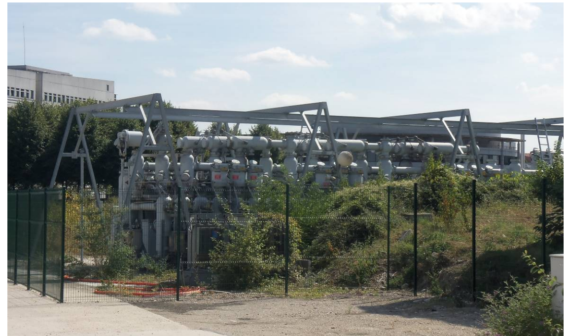
Poste électrique Saint-Denis (Source : MEDIATERRE Conseil)
