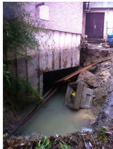
Photo 1 : Brèche de l'hôtel Ibis Style lors de la crue de janvier 2014 à Dax (Source : Ville de Dax)
