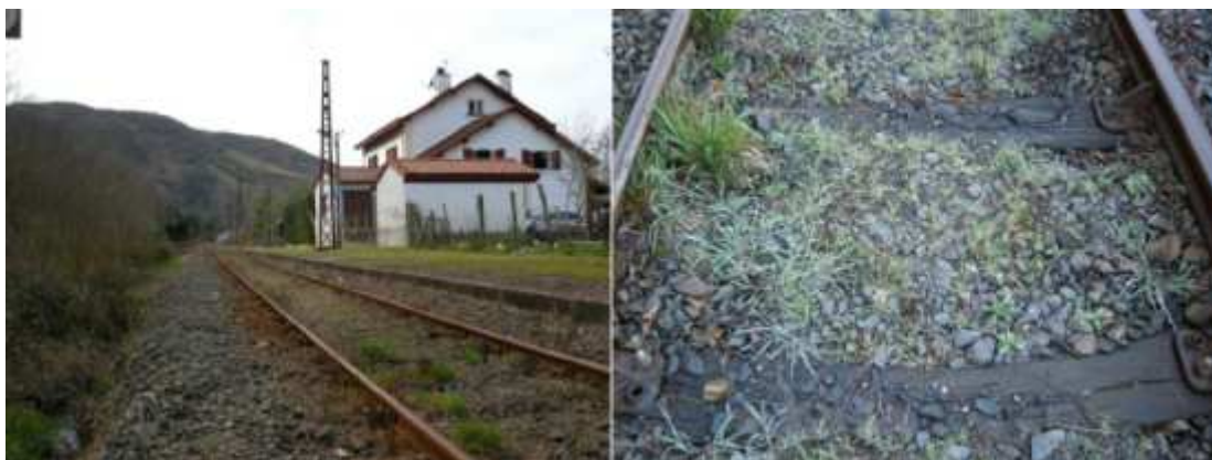
Ballast encombré de végétation à la halte d'Ixassou au PK 244+750
