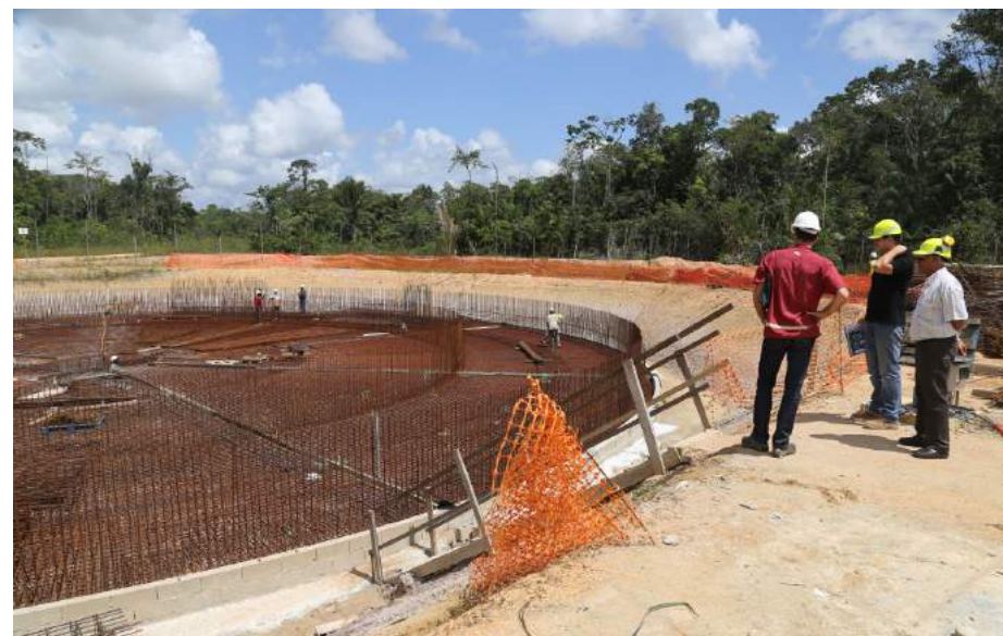
Usine de traitement d'eau potable de Saint-Laurent-du-Maroni © DEAL
