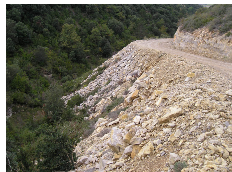
Exemple de piste en déblai-remblai, en fin de chantier d'installation du parc de Roquefixade (11)
