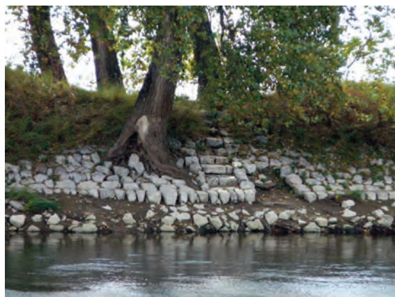
Fig. 200 : Dégradation d'un duit par développement d'une végétation non maîtrisée. (Photographies Diren Centre, 2008)
