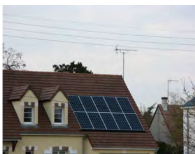
Fig. 154 : Impact visuel de panneaux solaires en milieu de toiture, contrastant avec le matériau de couverture
