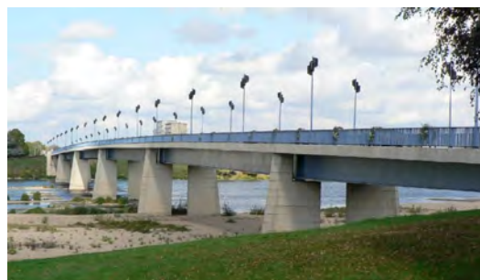
Fig. 132 : Une structure de tablier épaisse qui alourdit la silhouette de l'ouvrage. Un poids de l'éclairage non négligeable. (Photographie Diren Centre 2006).
