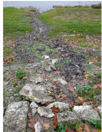
Fig. 41 : Rejet de canalisation érodant et dégradant le pavage. (Photographies Diren Centre, 2008)
