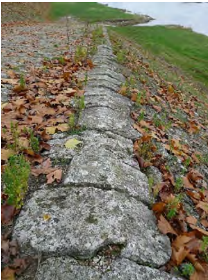
Fig. 39 : Envahissement progressif par une végétation herbacée. (Photographies Diren Centre, 2008)
