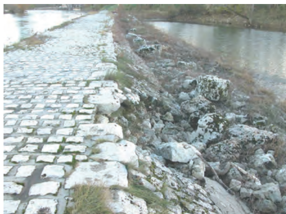
Fig. 199 : Affouillement en pied de duit. (Photographies Diren Centre, 2008)
