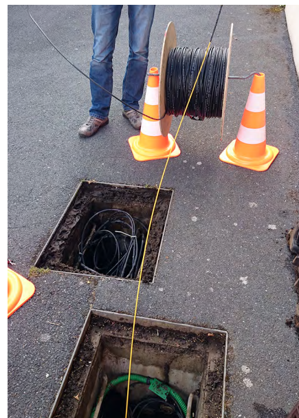
Déploiement de la fibre optique
