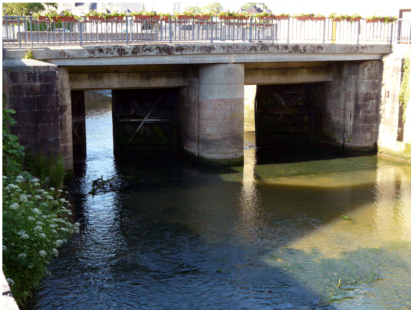
Portes à flot du pont au Douet à Isigny-sur-Mer (14)
