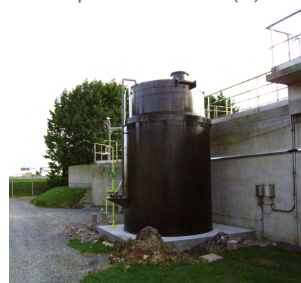
Station d'épuration de Ouistreham (14)
