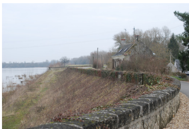
8. Les ouvrages de levée sont envahis par la végétation
