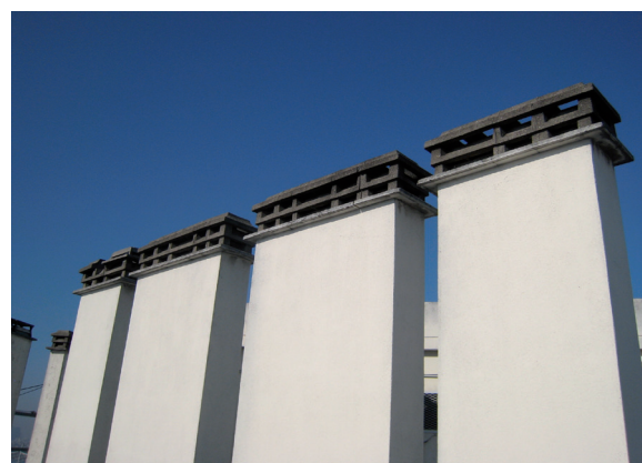
Conduits de ventilation naturelle
