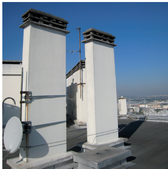
Conduits de ventilation naturelle
