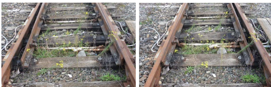
Figure 7 : Branchement 102 : bonne application des aiguilles droite et gauche.
