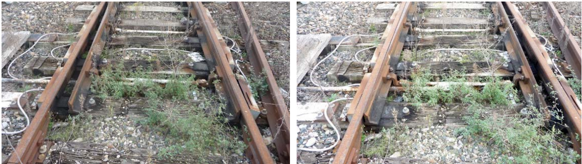
Figure 8 : Branchement 103 : Bonne application des aiguilles droite et gauche. Bon état général de l'appareil. Il est proposé de remplacer 4 bois.
