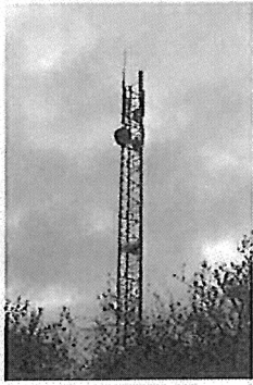
Image n°17 : Antenne relais télécommunications
