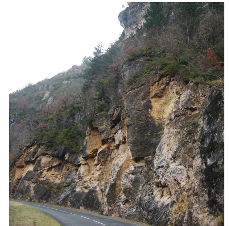
En amont de Montbrun, ces rochers qui semblent tenir naturellement en équilibre sont maintenus par des ancrages.
