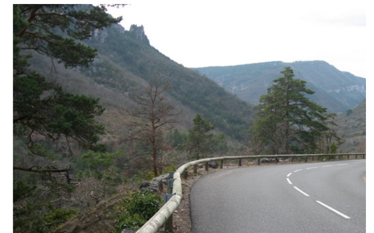
La lisse en bois n'est heureusement pas utilisée systématiquement et reste réservée pour les sections les plus boisées, exposées à l'Ubac.
