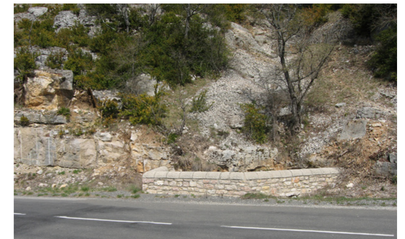
Petit ponceau récemment construit en aval de Blajoux. L'ouvrage crée un petit événement discret parfaitement intégré.
