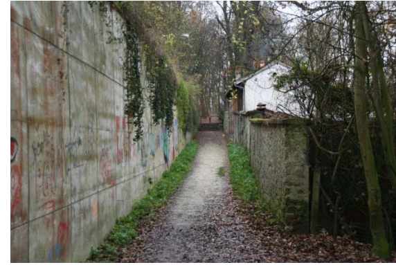
Photo 12 : Le remblai tagué chemin de la Sygrie : le promeneur est enfermé entre le mur du remblai et les murs des propriétés, le bruit de la circulation dégrade encore plus ce lieu de promenade
