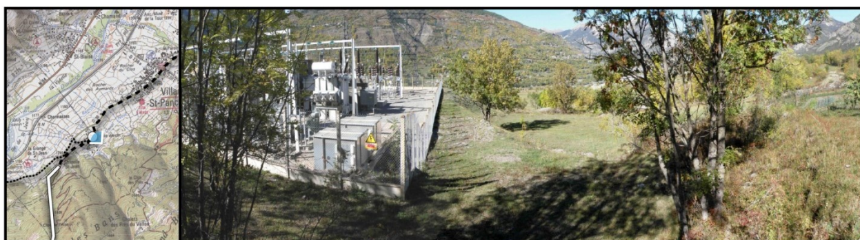
Poste électrique de Briançon
