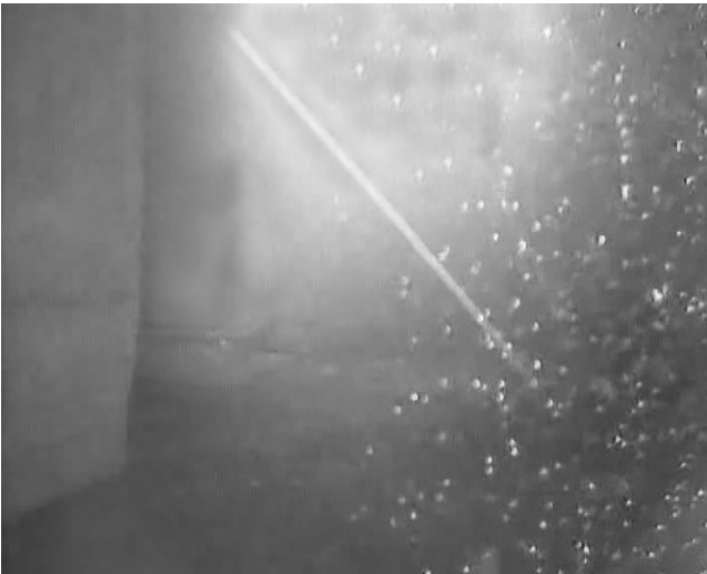
photo 21: Photo d'une galerie inondée
