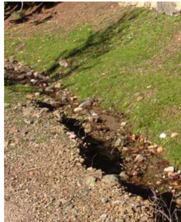
Ruissellement non canalisé
