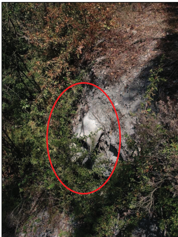
Photographie 47 – Buse brisée suite au glissement du sol d’assise
