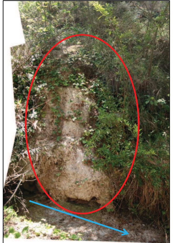
Photographie 39 – PK 15.900 – Descente d'eau située à l'aval de l'OH de traversée – Encroustement de tuf calcaires (en blanc)
