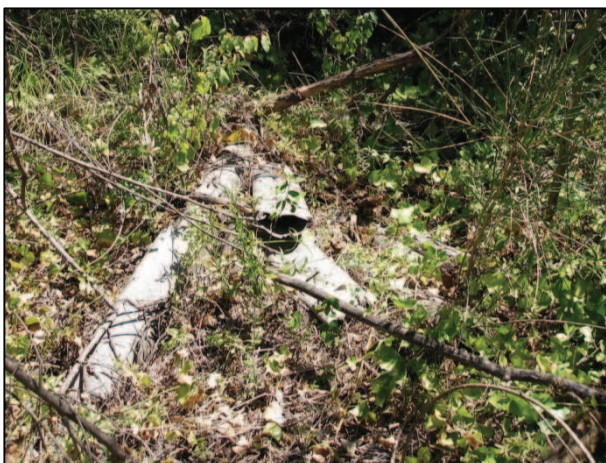
Photographie 43 – Conduites brisées
