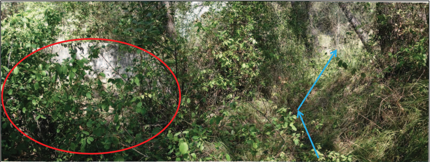
Photographie 42 – Bassin tampon (rouge) en aval de la descente d'eau en sortie de l'ouvrage hydraulique de traversée – Descente d'eau cassée (bleue) à cause des déformations liées au glissement et ne se rejetant plus dans le bassin tampon
