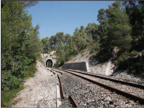
Photographie 32 – Tunnel au PK16 – Descente d'eau à droite et fossés maçonnés longitudinaux en pied de déblai
