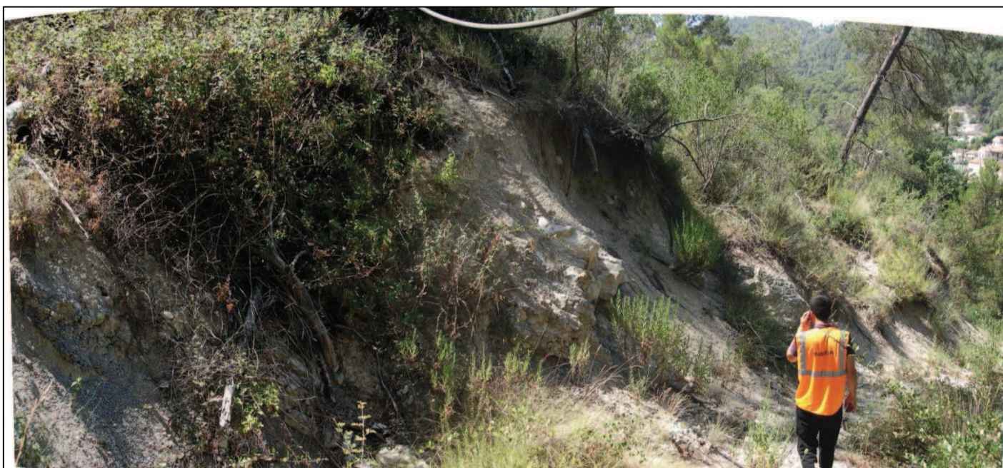
Photographie 26 – Erosion du versant liée à la réalisation du sentier d'accès au tunnel ferroviaire situé – Conduite d'alimentation en eau suspendue en limite supérieure de la photographie
