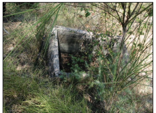
Photographie 44 – Petit bassin et conduite d'alimentation en eau avec robinet obsolètes
