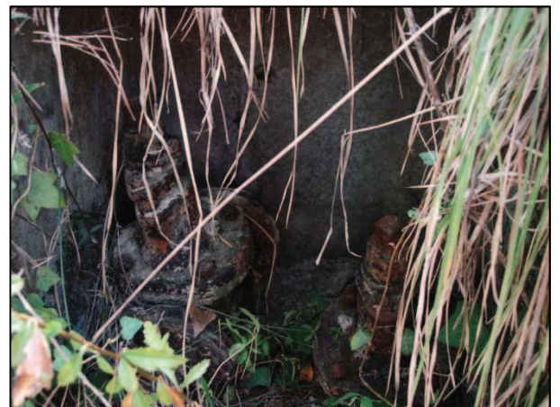
Photographie 40bis – Vannes dans le regard (lien probables avec le captage de la source en amont de la voie ferrée)
