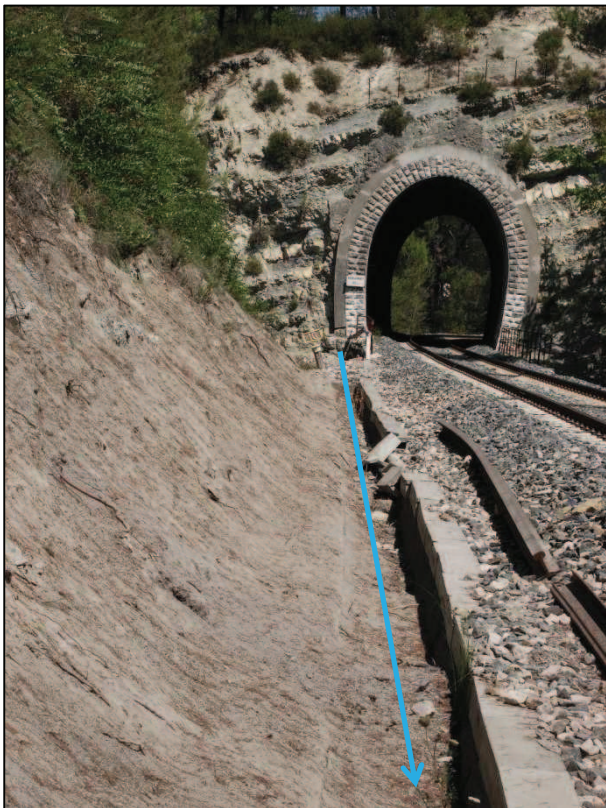
Photographie 36 – PK 16.000 - Tunnel côté Breil – Fossé maçonné à curer
