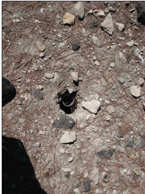
Photographie 34 – Sondage inconnu non rebouché – Possibilité d'infiltrations dans le remblai ferroviaire
