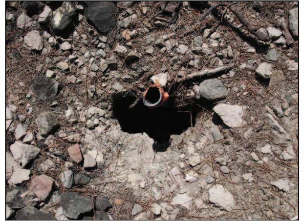
Photographie 33 – Sondage inconnu non rebouché – Possibilité d'infiltrations dans le remblai ferroviaire
