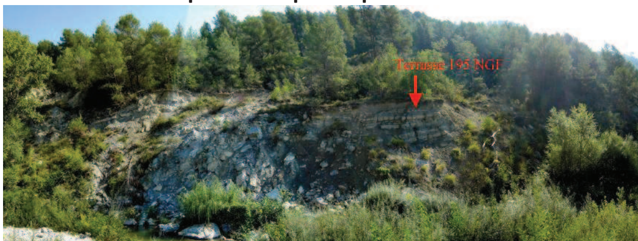
Illustrations 9 et 10 : Glissement constaté après l'épisode pluvieux de novembre 2000 (Source : CETE, 2011)
