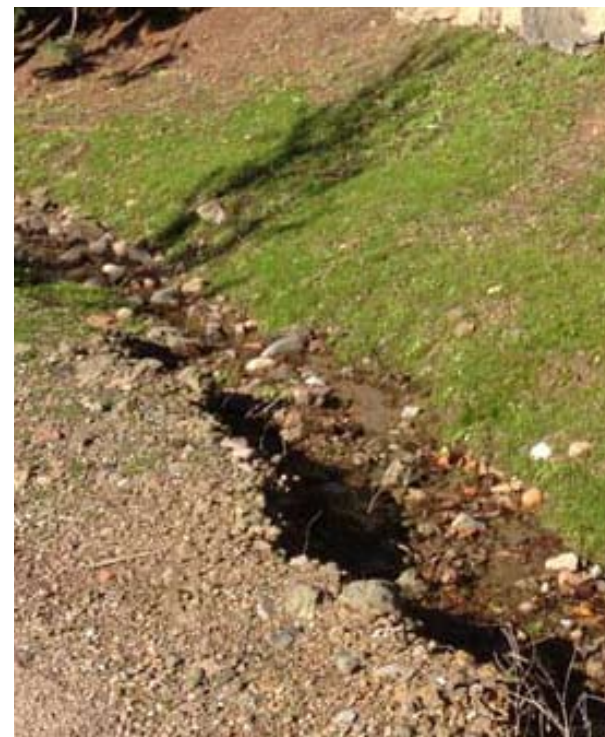
Ruissellement non canalisé
