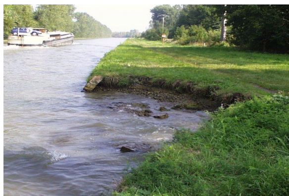
Illustration 4 : Anse d'érosion de berges [source CETMEF]
