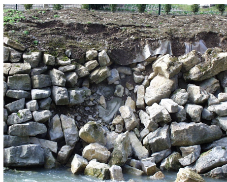
Illustration 6 : Glissement de blocs en enrochements [source CETMEF]
