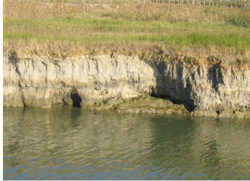
Illustration 5 : Perte de matériaux favorisée par les caractéristiques médiocres du sol [source CETMEF]
