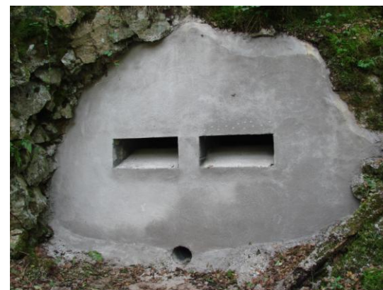
Aménagements de sécurisation minière avec lucarnes pour le passage des animaux (galerie 68)
