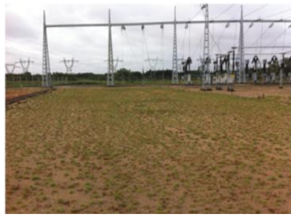
Exemple de couverture végétale sur les abords des installations électriques (source : RTE)
