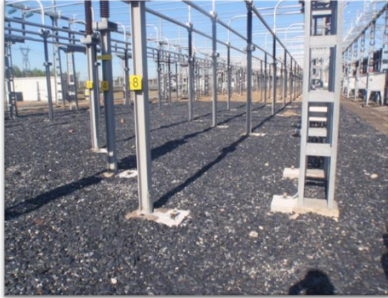
Exemple de paillage minéral sous les installations électriques (source : RTE)
