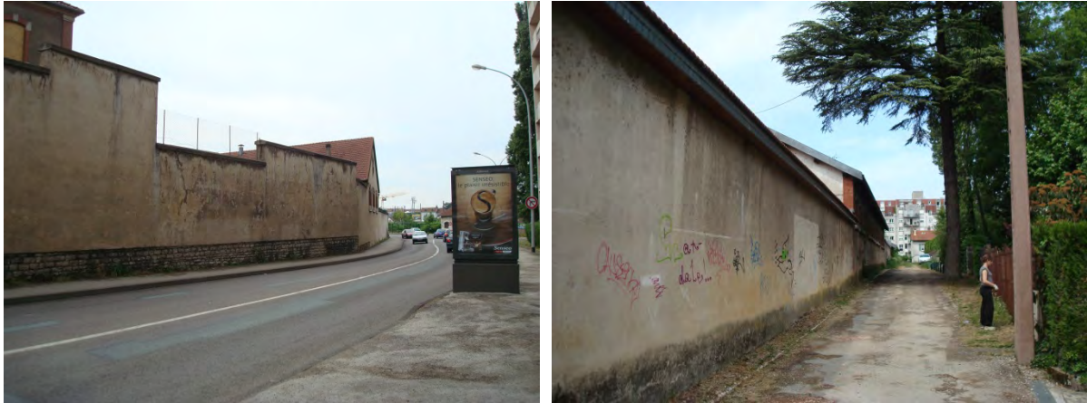
Le site d'étude vue depuis la rue Voirin et depuis le chemin côté rue Jean Querret
