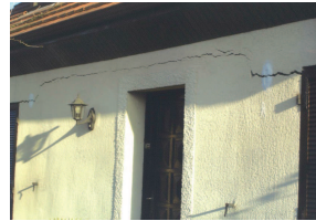
Désordres sur le bâti (maisons individuelles les plus vulnérables)
