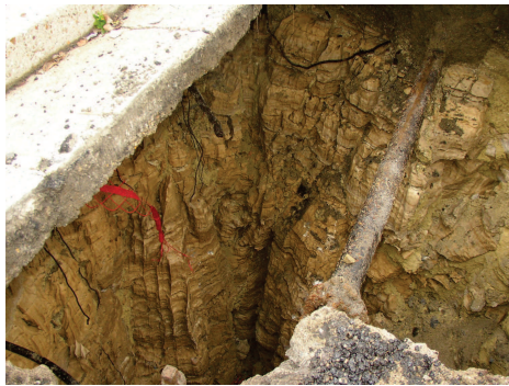
Exemple d'effondrement de chaussée suite à des fuites du réseau d'assainissement – Commune de Villetaneuse, butte de Montmorency
