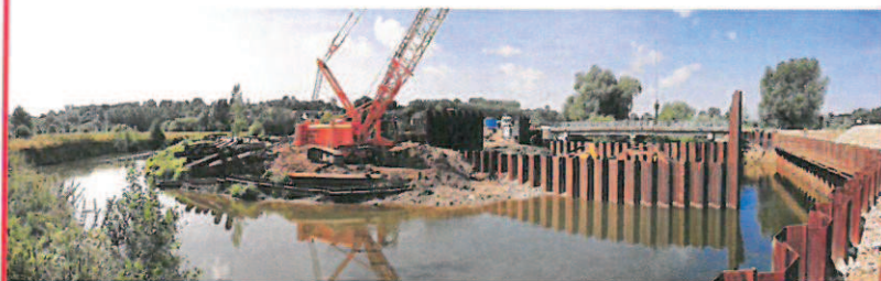
Travaux de prévention du risque inondation : site d'écrêtement des fortes crues de l'Oise de Proisy (02) réalisé par l'Entente Oise Aisne et achevé en 2009.
