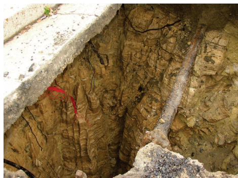
Exemple d'effondrement de chaussée suite à des fuites du réseau d'assainissement – Commune de Villetaneuse, butte de Montmorency
