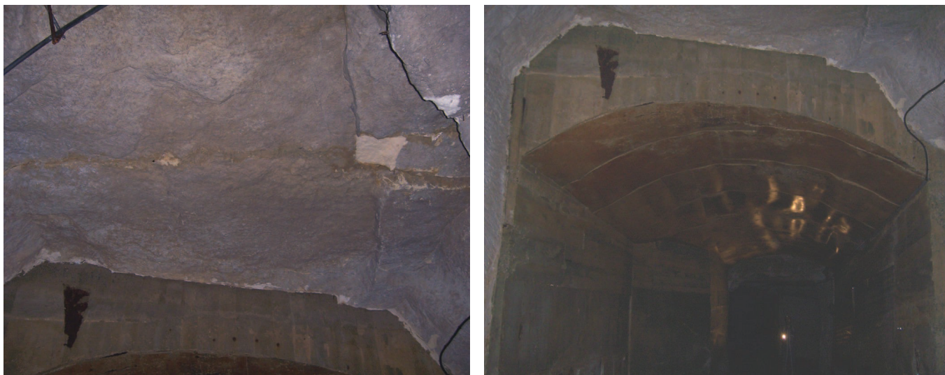
Photo 9 : Détail du ciel fracturé dans la zone du fontis ayant été consolidé par une voûte béton (carrière Noris)
