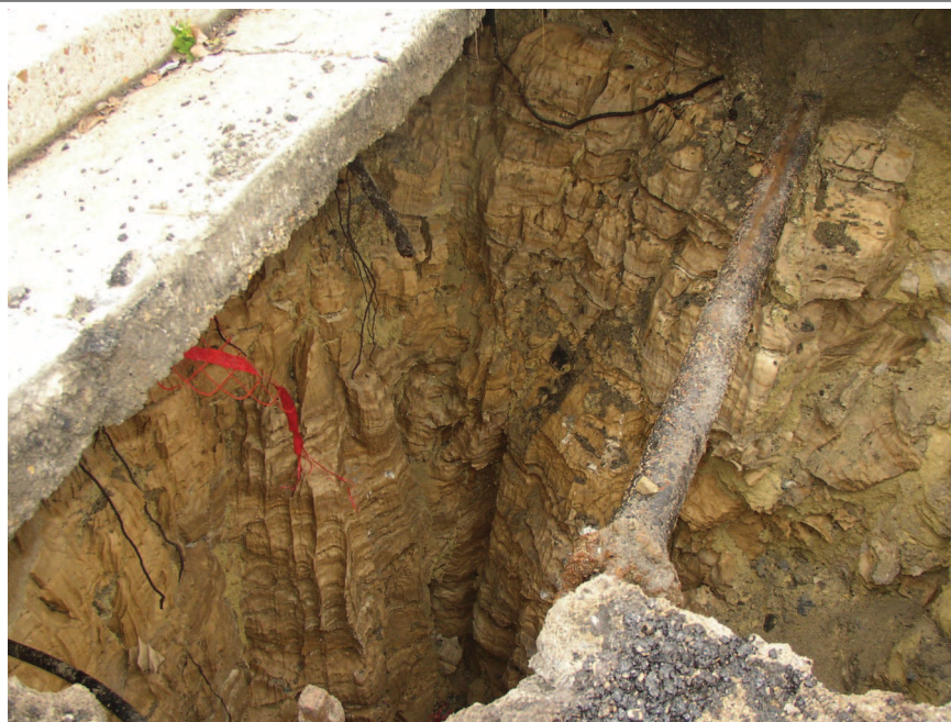
Figure 15- Exemple d'effondrement de chaussée suite à des fuites du réseau d'assainissement – Commune de Villetaneuse, butte de Montmorency (photographie source CEREMA)
