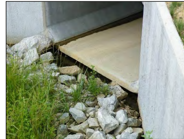
Exemple d'ouvrage hydraulique (OH 2 bis) présentant un seuil infranchissable pour certaines espèces de la microfaune
