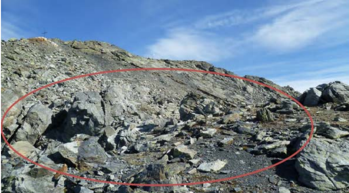
Photo 3 Site d'implantation de la gare aval du télésiège du Montvalaizan Source : Géode, septembre 2012
