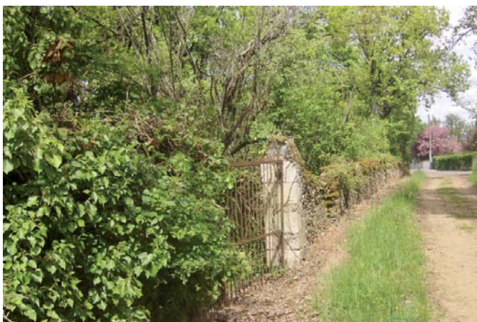
Num de la photo: 3861 Mur de pierre en partie effondré en bord de chemin vers le village de Saint-Jouin, portail en pierre de taille
