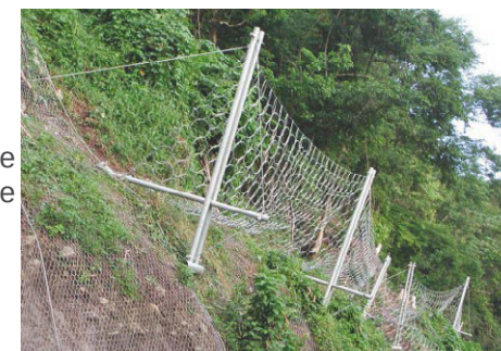
Photo n°9 : Filets de protection
