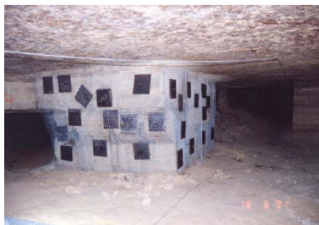
Photo n°8 : Pilier renforcé par grillage et boulonnage (carrière de la Brasserie, Vincennes)
