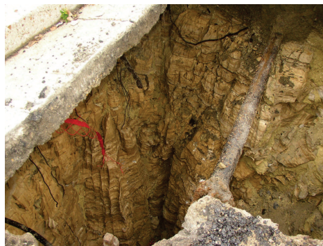
Exemple d'effondrement de chaussée suite à des fuites du réseau d'assainissement – Commune de Villetaneuse, butte de Montmorency
