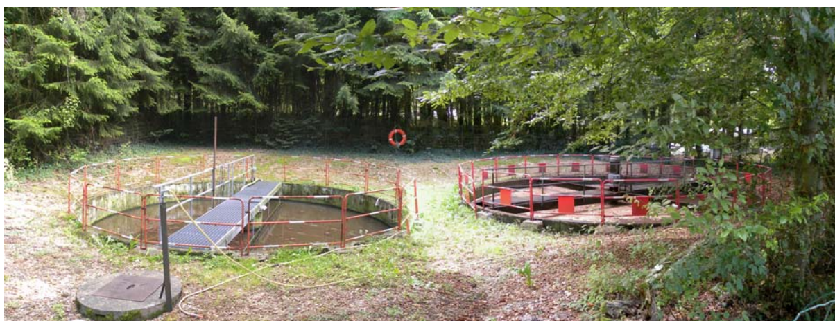
Station d'épuration du restaurant (1300 EH)
