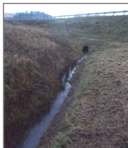
Figure 34 : Vue sur le passage busé rétablissant le Verdin sous l'autoroute A71 – Vue de l'aval de l'autoroute (Source : GENIVAR, 2011)
