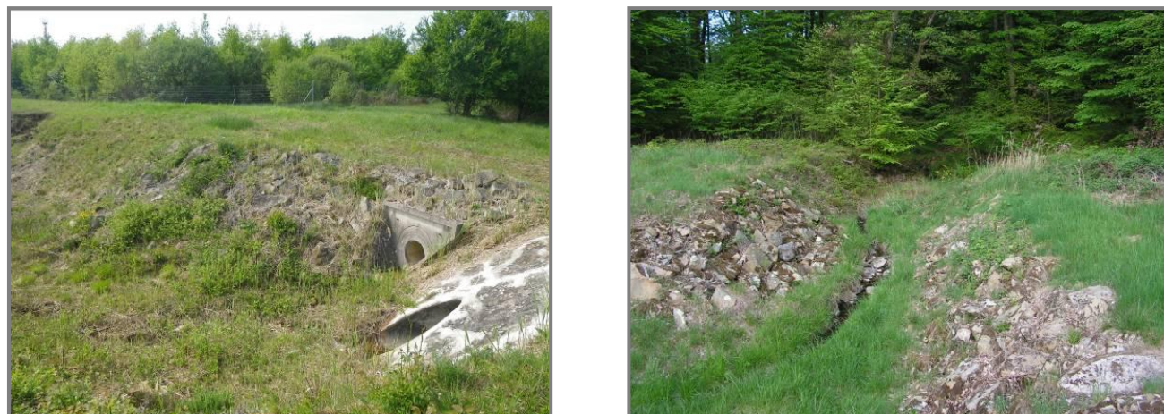
Photographie n°45 : Eléments bétonnés et empièvements des aires d'étude favorables aux reptiles.
