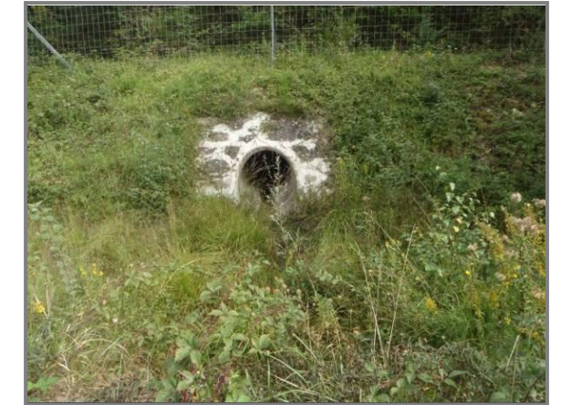
Photographie n° 14 : Passage busé de l'affluent 1 sous l'autoroute A71- Vue vers l'amont (aval de l'autoroute A71) (Source : GENIVAR)
