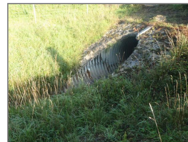
Figure 37 : Passage busé de l'affluent 2 sous l'autoroute A71 – Vue vers l'amont (aval de l'autoroute A71)
