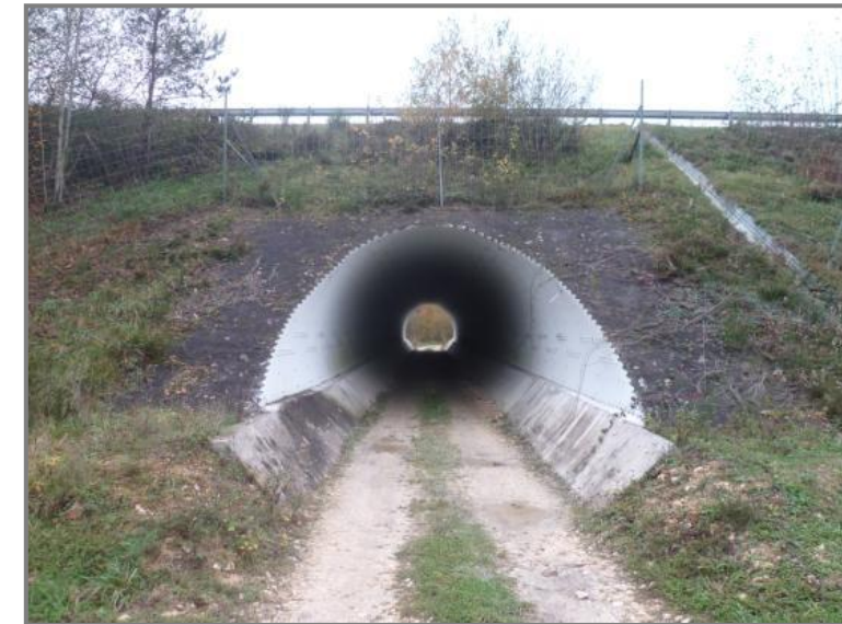
Photographie n°3 : Passage inférieur (PR 175 +710) : route forestière de la Plaine – Vue vers l'est (Source : BLG Environnement, novembre 2011)
