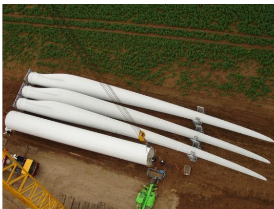
Stockage temporaire des pales au pied des mâts Parc Eolien du Chemin d'Ablis – EDF Energies Nouvelles
