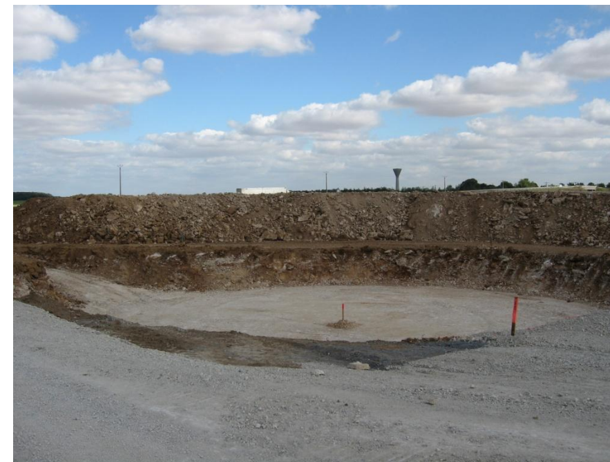
Fondation excavée et remblais – Parc Eolien du Chemin d'Ablis – EDF Energies Nouvelles
