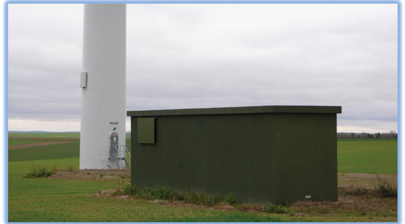
Figure 145 : Exemple de photo de poste de livraison
