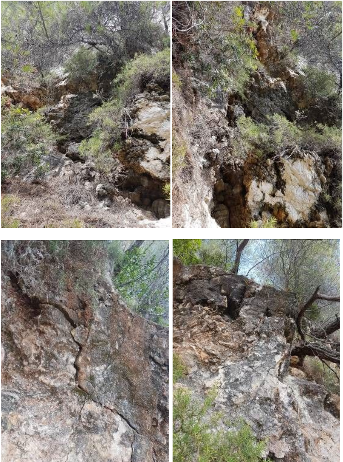
Photos réalisées dans le 1 er tiers de la falaise, ensemble très fracturé et fissures largement ouvertes, entraînant l'individualisation de blocs de taille plurimétriques.
