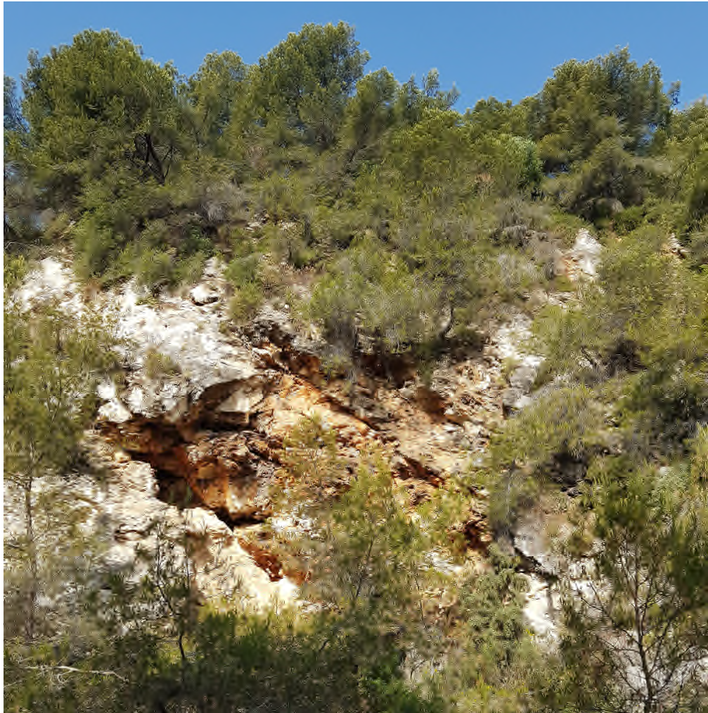
Figure 17 : photo de la falaise dans la zone 2, l'orientation et l'inclinaison des plans de stratigraphie et bien identifiable, le développement des cavités entraînent la désolidarisation de blocs rocheux.
