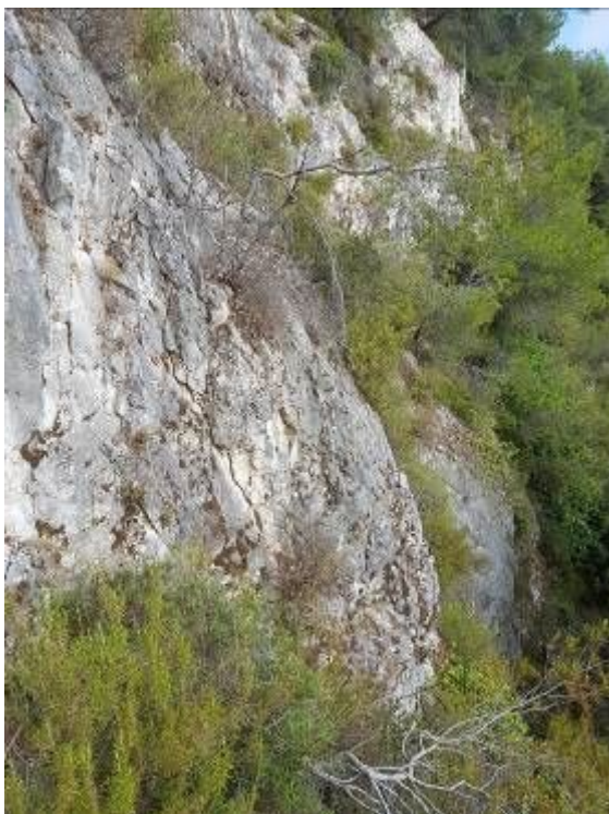
Ecaillage de surface
