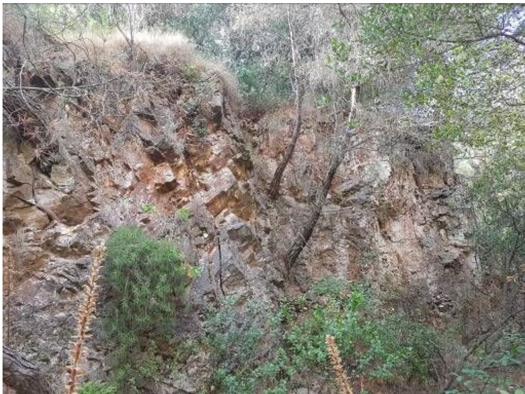
Zone très fracturée, présence de masses rocheuses de forme parallélépipédique, très décollées par les combinaisons des fractures.
