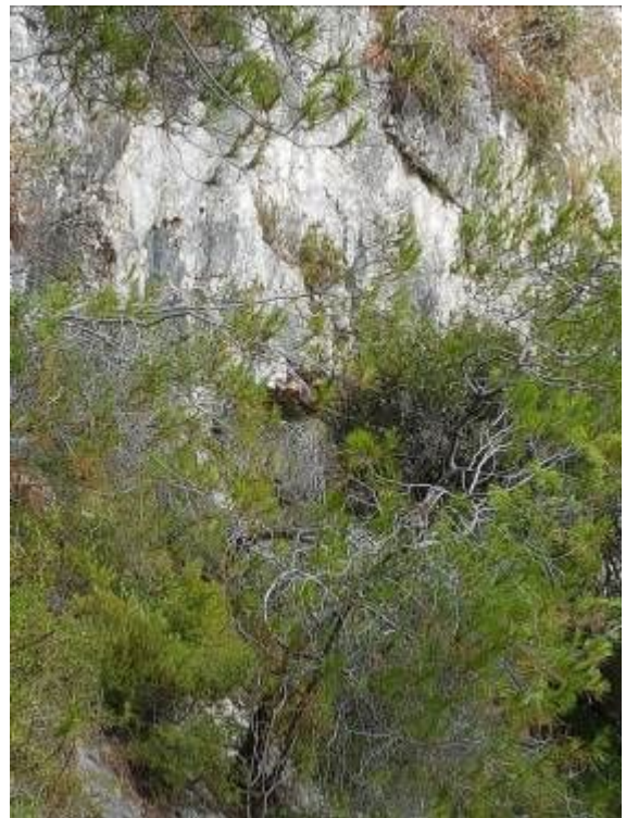
Ecaillage de surface et cavité karstique
