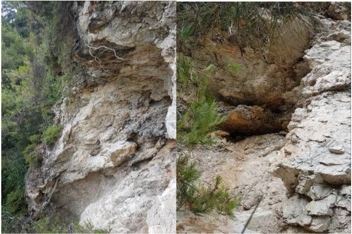
Photo de la zone soucavée caractérisée par un calcaire dolomitique blanchâtre très altéré et présence de blocs et blocailles en pieds
