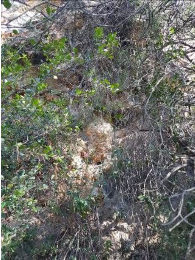
Photo zone soucavée en sortie de balme
