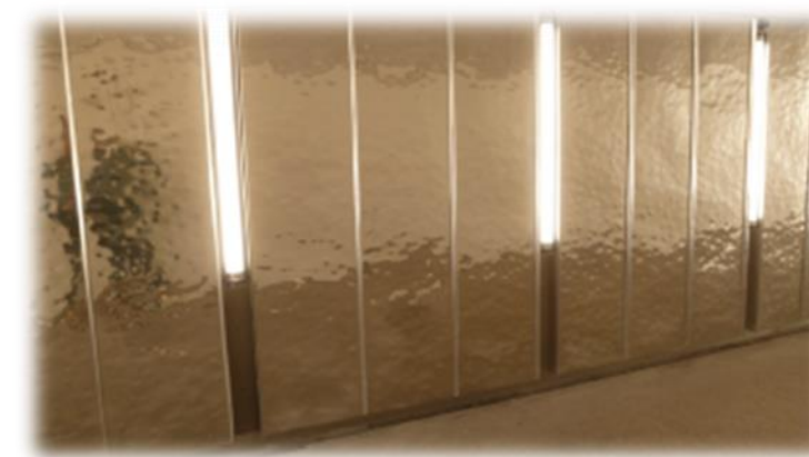
Photo 95 : Exemple de parement mural réfléchissant rythmé par un éclairage en applique - Gare de DOMONT (AREP)
