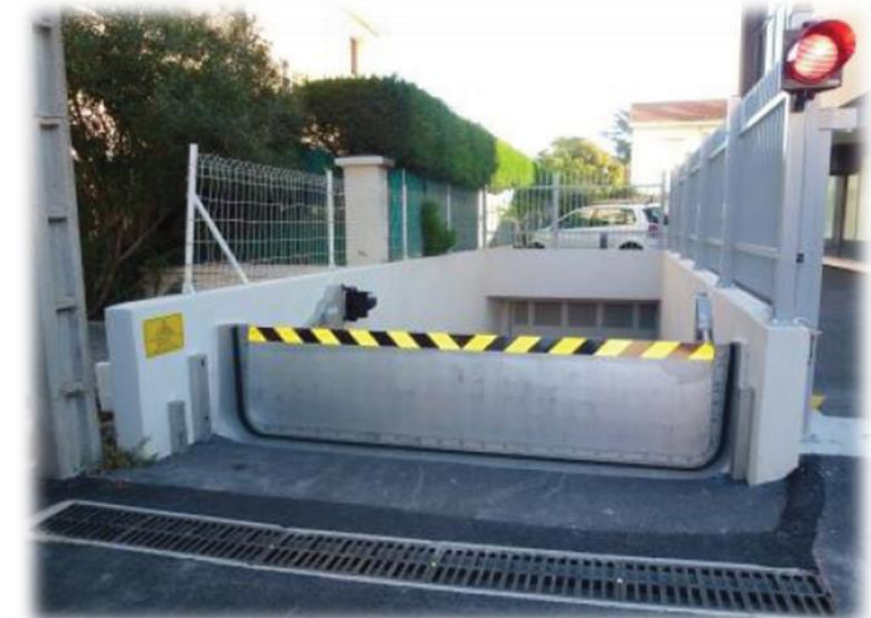
Photo 103 : Exemple de barrière mobile en fonctionnement (AREP)
