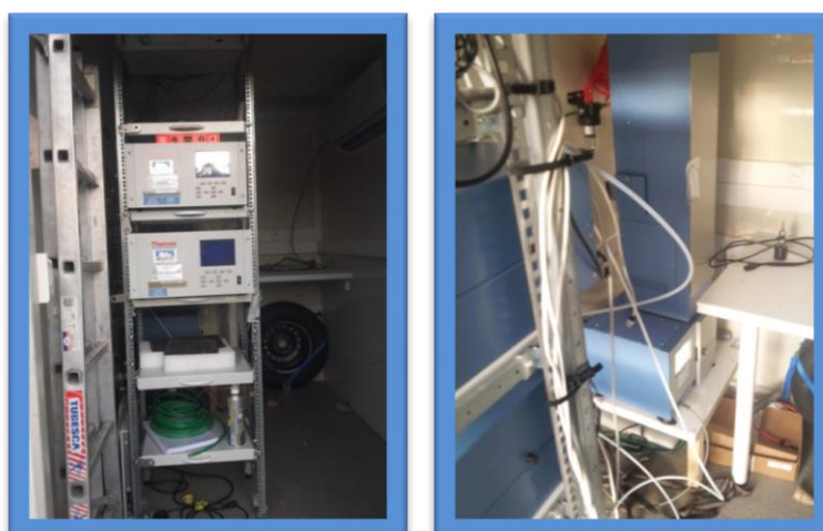
Figure 5 : Station mobile : intérieur de la remorque
