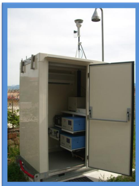
Figure 3 : Intérieur d'une station de mesure
