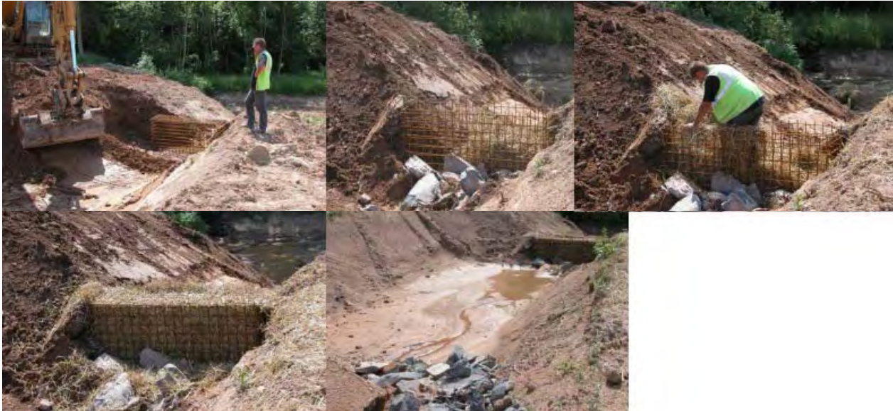
Figure 58 : Illustration de la mise en œuvre d'un système de filtre à paille (Source : Cerema, 2015)
