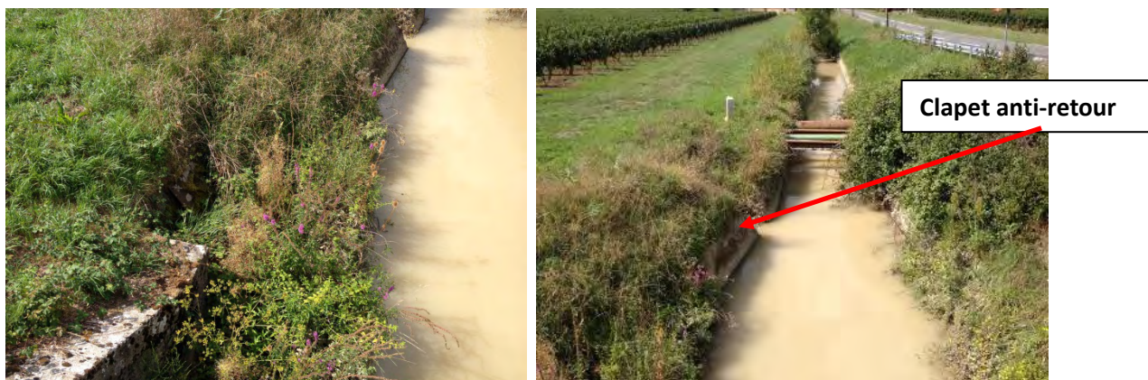
Figure 8 : Présence d'un clapet anti-retour peu visible avec le développement de la végétation (mégaphorbiaie) (Source Simethis).
