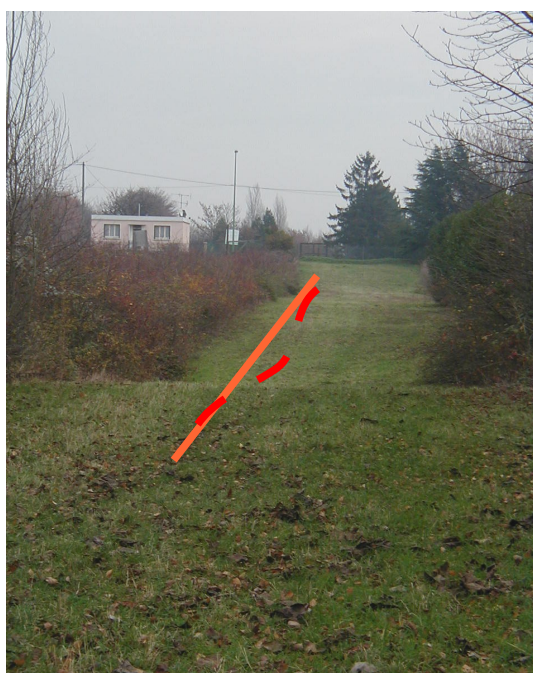
Figure 12- Exemple d'affaissement de terrain dans le cas de la dissolution de niveaux résiduels de gypse sub-affleurant – Butte de Vaujours en Seine-Saint-Denis (photographie source CEREMA)
