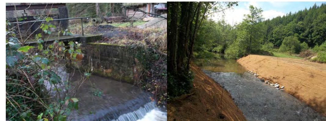
Photo 29 : Illustrations avant/après d'une suppression d'ouvrage par mise en place d'une rampe en enrochement sur la LGV Est Européenne (source Setec)
