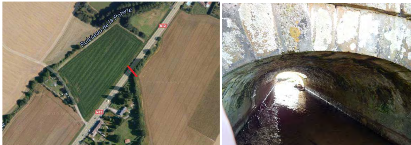
Illustration 144 : Ouvrage hydraulique du ruisseau de Charencey (source: Google Earth / SEGIC)
