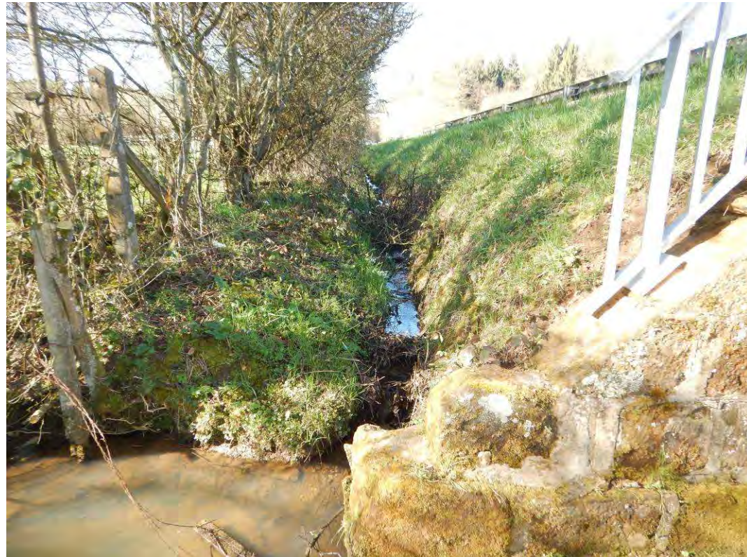
Illustration 38 : Photo du fossé au droit du ruisseau de Charencey (source : SEGIC)
