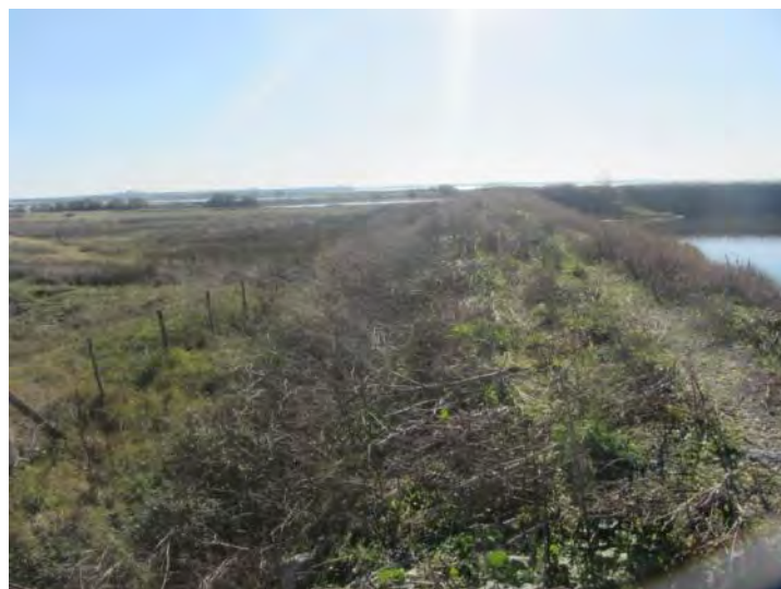
Vue sur la digue en retour vers l'est à l'intérieur de la réserve (remblais en pente repris après Xynthia) formant l'enceinte de la zone SACOM, prise vers l'ouest
