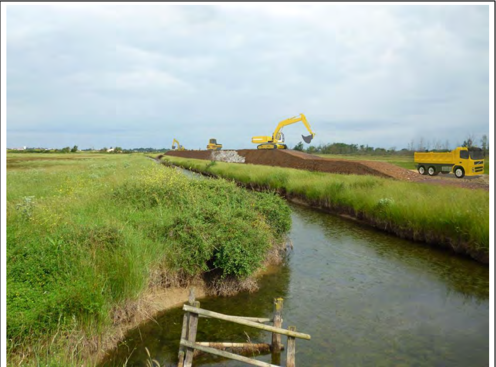
Vue en cours de travaux (phase temporaire) – prairie le long du fossé syndical – mois de juin
