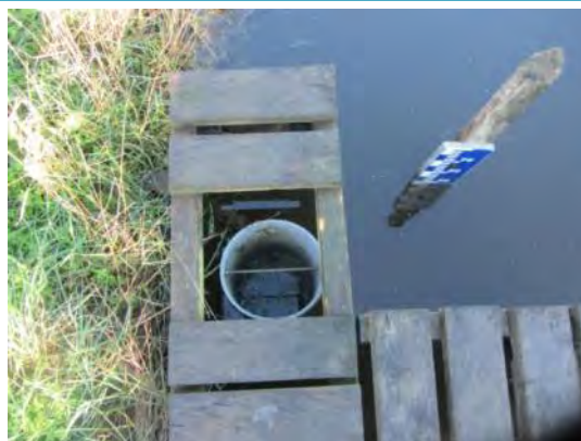
Détail sur la conduite de surverse
