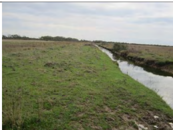
Photographie 16 : passage dans des prairies au niveau du bourrelet de curage (?), moins humide
