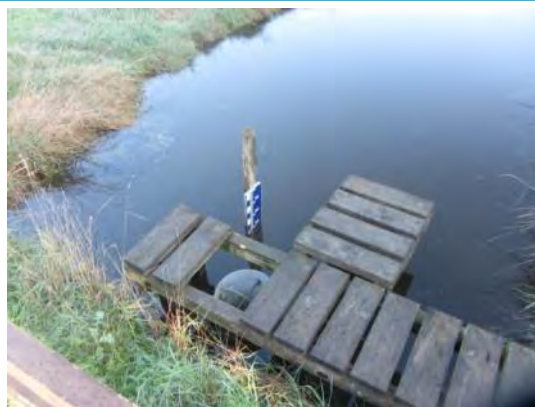
Vue sur la conduite de surverse et l'échelle limnimétrique
