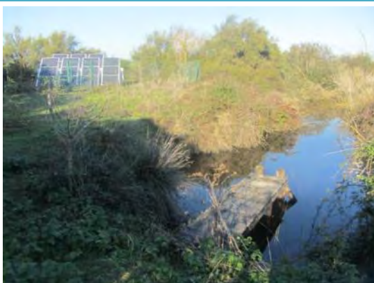
Vue sur la pompe et les panneaux photovoltaïques
