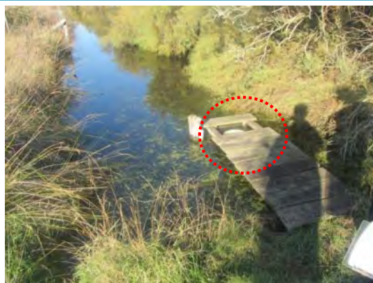
Vue sur la passerelle bois d'accès et la buse PVC de surverse
