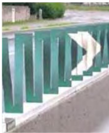
Figure 125 : Exemple de dispositif anti-éblouissement sur une glissière béton
