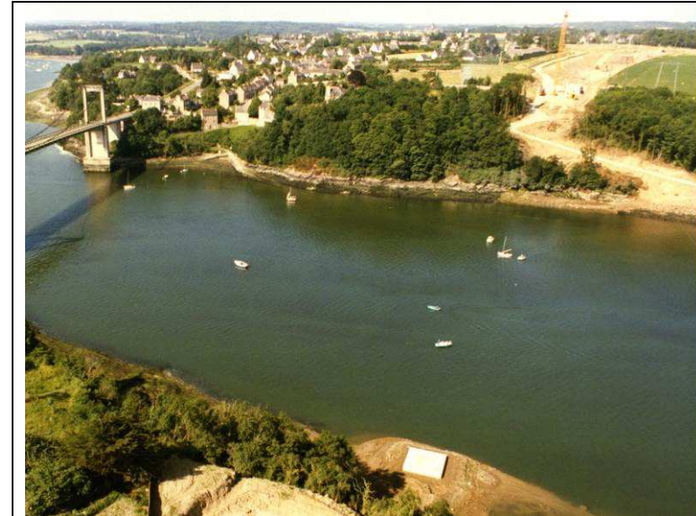
Photographie 7 de 1989 lors de la réalisation du pont Début des travaux de construction du pont Châteaubriand : on peut voir la piste d'accès qui a été créée dans le boisement, homogène du point de vue de la végétation, côté ouest de la Rance.
