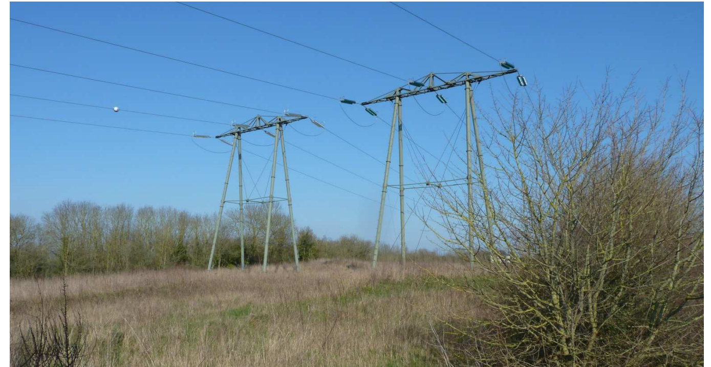
Photographie 36 : La ligne électrique THT 225 kV au nord de Port Saint-Jean
