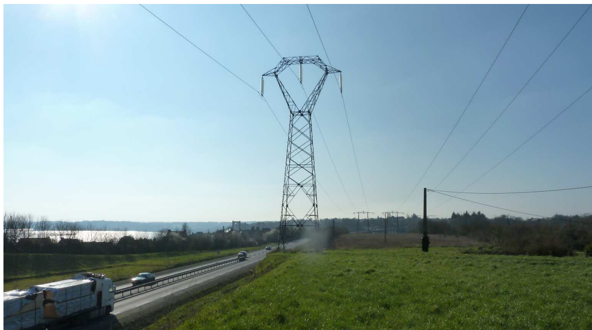
Photographie 39 : La ligne EDF THT 225 kV longeant la RN176 au nord de Port Saint-Jean
