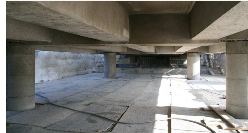
Figure 106 : Exemple de chantier d'hydrodémolition et reconstitution du béton d'enrobage - Pont de Kérisper (source CEREMA)
