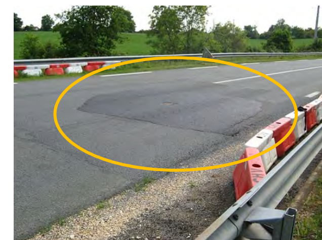
Zone remblayée suite à un effondrement sur RD 93 le 20/04/2009
